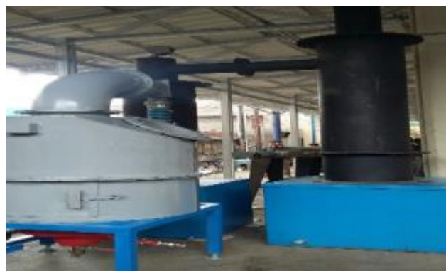
Gambar 5. Ruang pembakaran bahan bakar RDF, Cyclone dan wet scrubber
