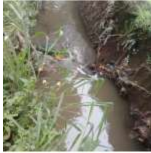
Gambar 2. Bagian sungai yang tidak ada tanggul
