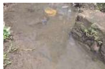
Gambar 2. Degradasi karena penggenangan air ( water logging )
